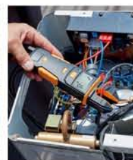
使用testo 755测量空调室外机电流
